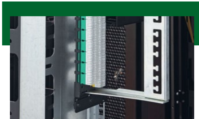
вертикальная установка коммутационной панели в 19" шкафу с помощью кронштейнов zero-u
