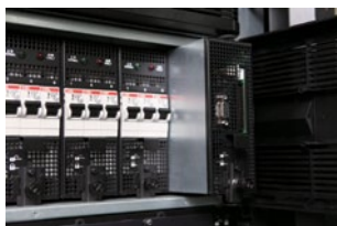
Модуль коммутационных аппаратов с возможностью горячей замены
