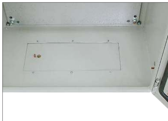
Заглушка, установленная в нижней части шкафа
