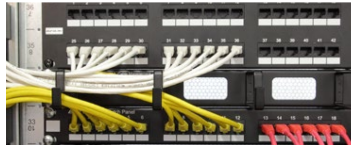
ГОРИЗОНТАЛЬНЫЕ ОРГАНИЗАТОРЫ ОБЕСПЕЧИВАЮТ ОТВОД КАБЕЛЕЙ К ВЕРТИКАЛЬНЫМ ОРГАНИЗАТОРАМ
